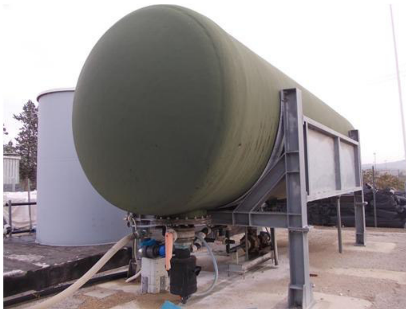
SERBATOIO DI 40.000 LITRI
