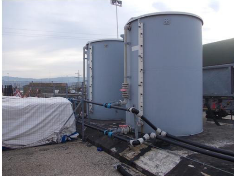
SERBATOIO DI 40.000 LITRI
